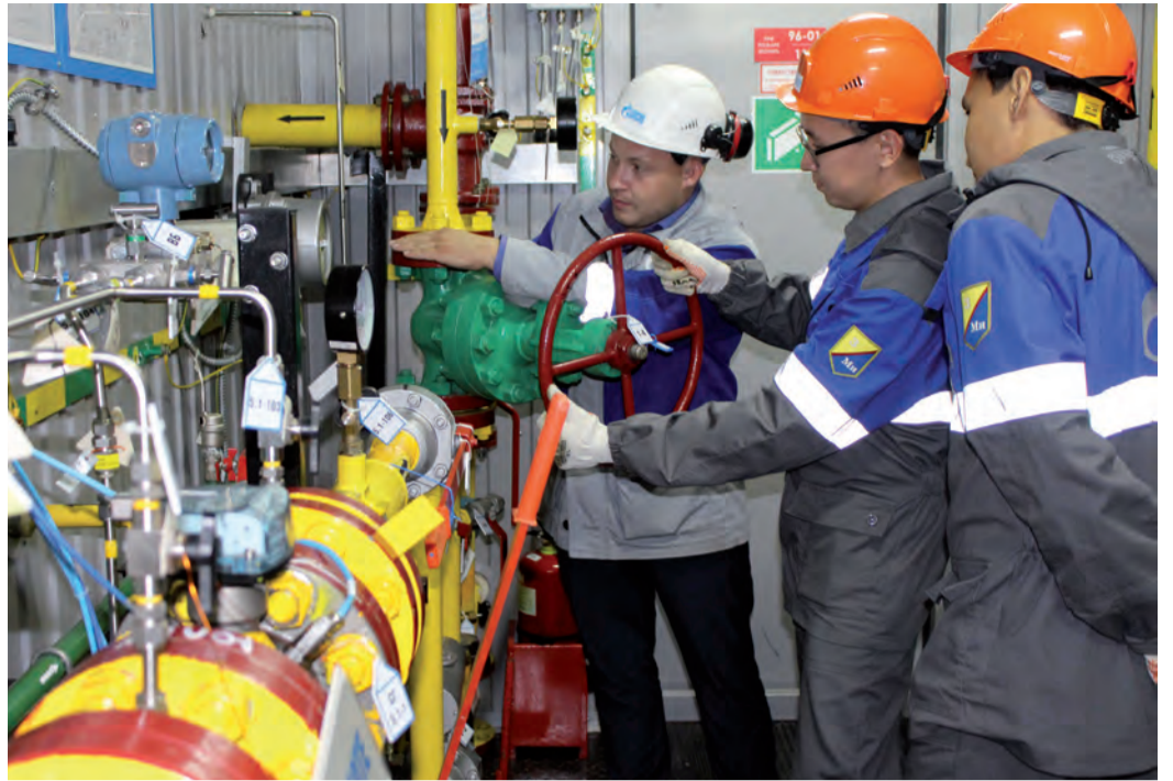
Студенты СВФУ имени М. К. Аммосова осваивают работу оператора ГРС в Юргинском ЛПУМГ
