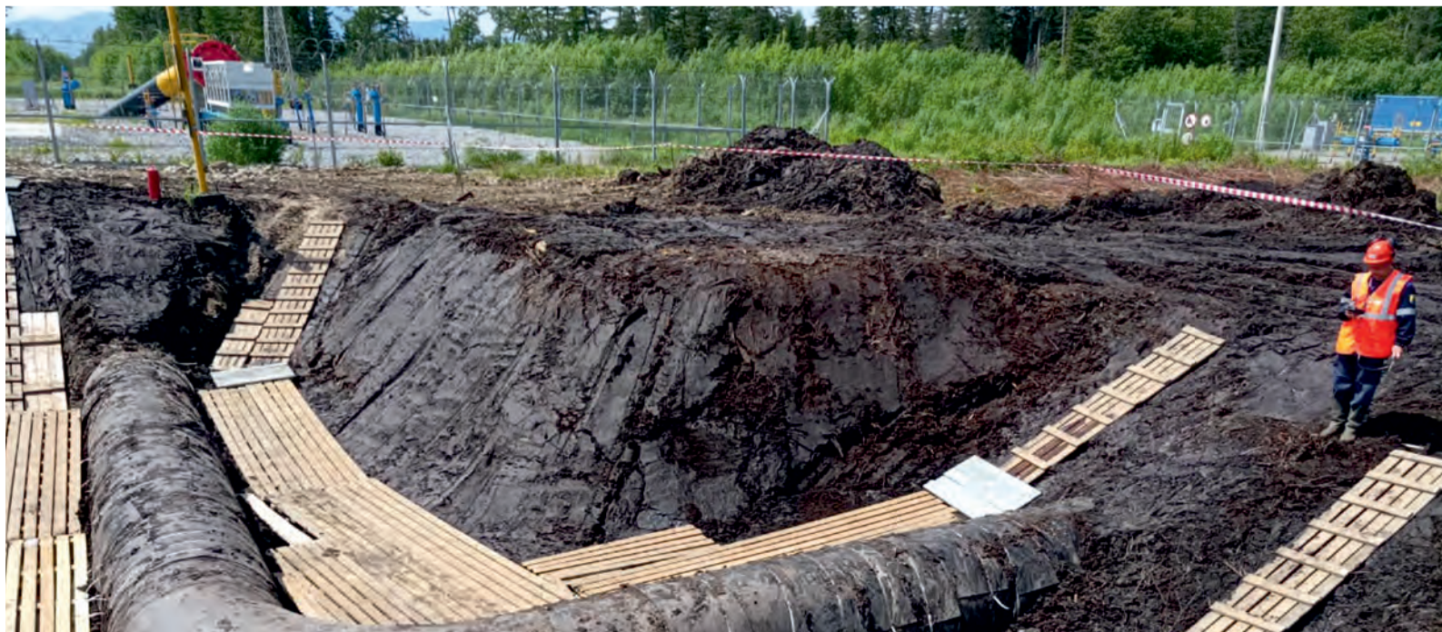
Из-за обильных осадков и высокой обводненности грунта газовики Амурского ЛПУМГ долго обустроивали место ремонта газопровода Сахалин – Хабаровск – Владивосток
