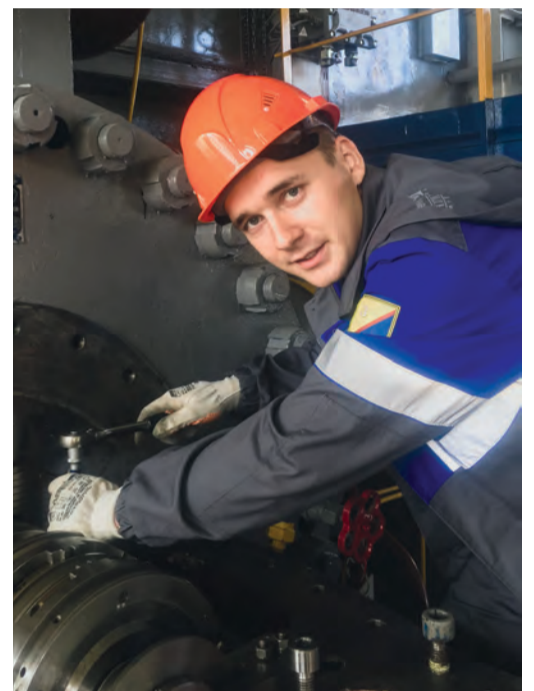
В ИТЦ студенты ТПУ проходили практику в качестве слесарей по ремонту технологических установок
